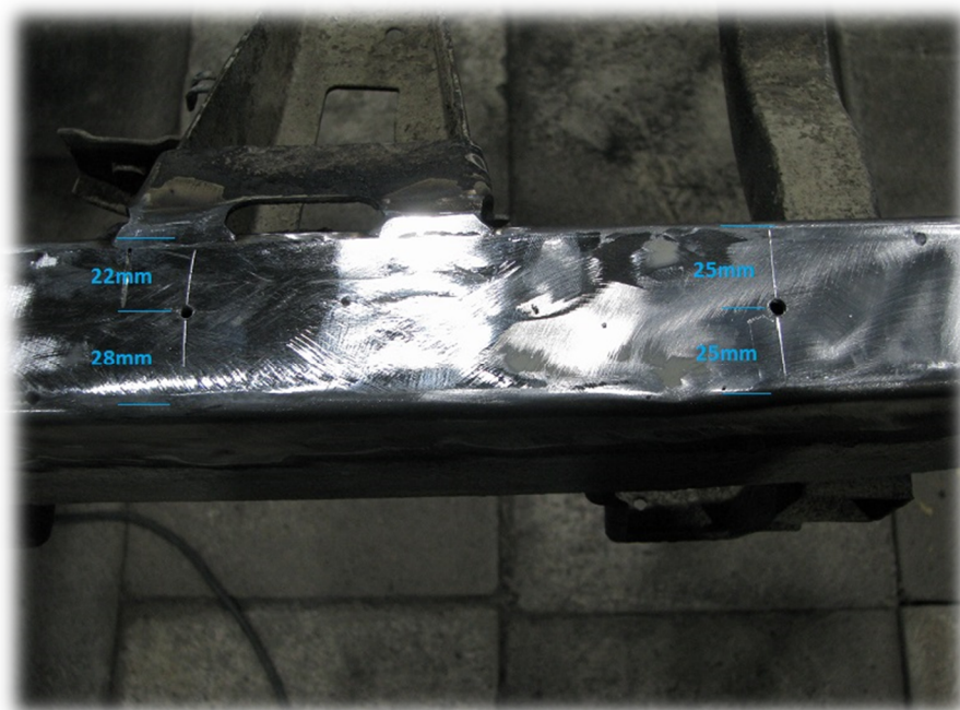
Fot.3 Widok od spodu na lewą (strona kierowcy) podłużnicę ramy.
